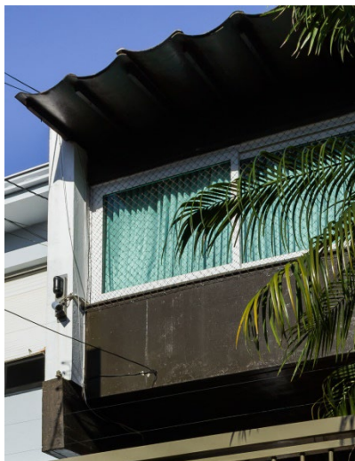
Figura 211. Detalhe da fachada principal já com alterações na materialidade das aberturas. Foto: Eduarda Furini.
